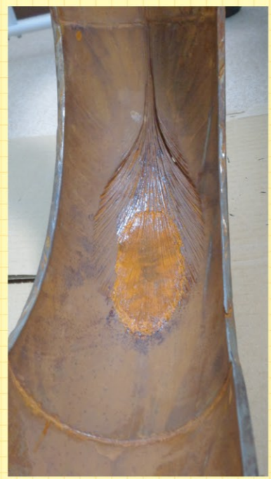
配管内の減肉損傷
