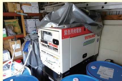
非常発電装置の導入
