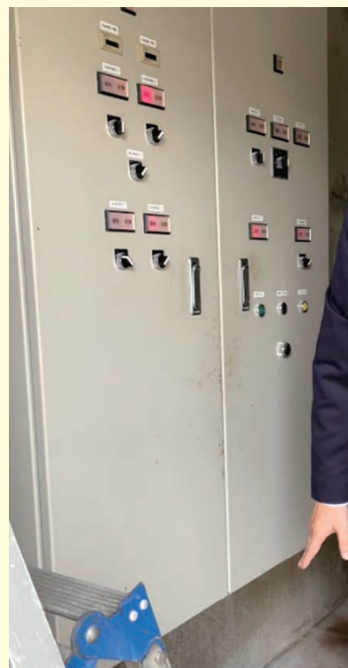
地面から配電盤までの高さを確認
