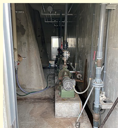
ブローワー機の確認
